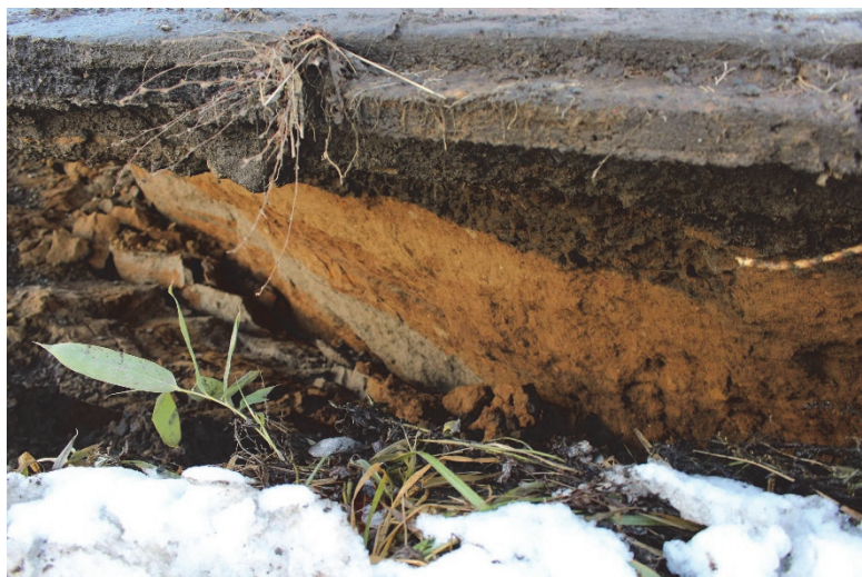
写真4 崩壊路盤下（地山側）の状況
