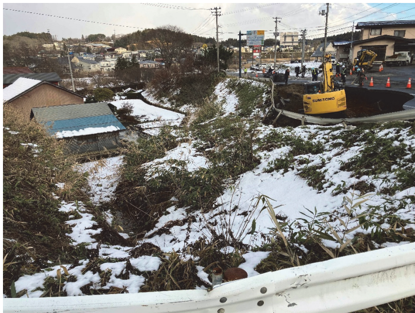
写真2 被害現場 乙供駅方面に向かって撮影
