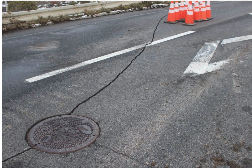
写真5 崩壊箇所外側の周囲にも生じた亀裂
