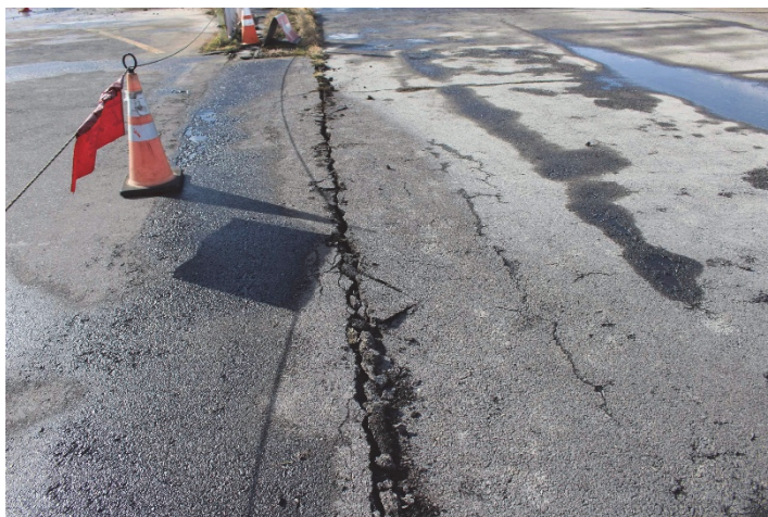
写真 14 目地部の段差
