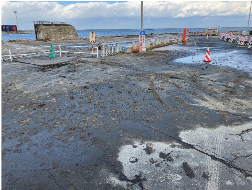
写真 9 液状化被害箇所全景
