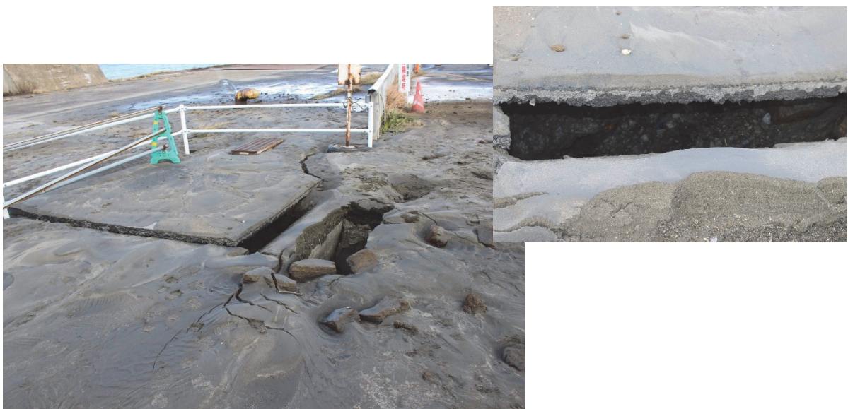
写真 12 集水枡付近からの噴砂状況
