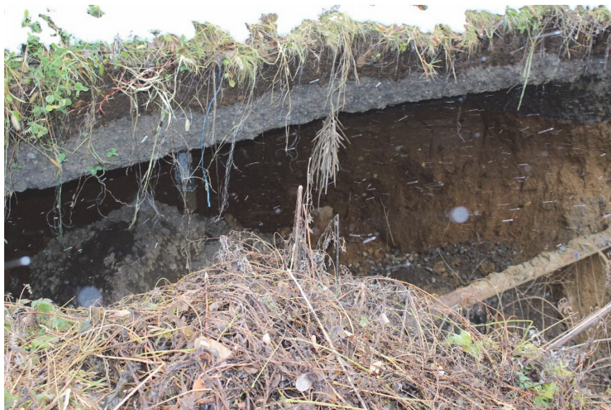
写真 7 道路路盤下の崩壊
